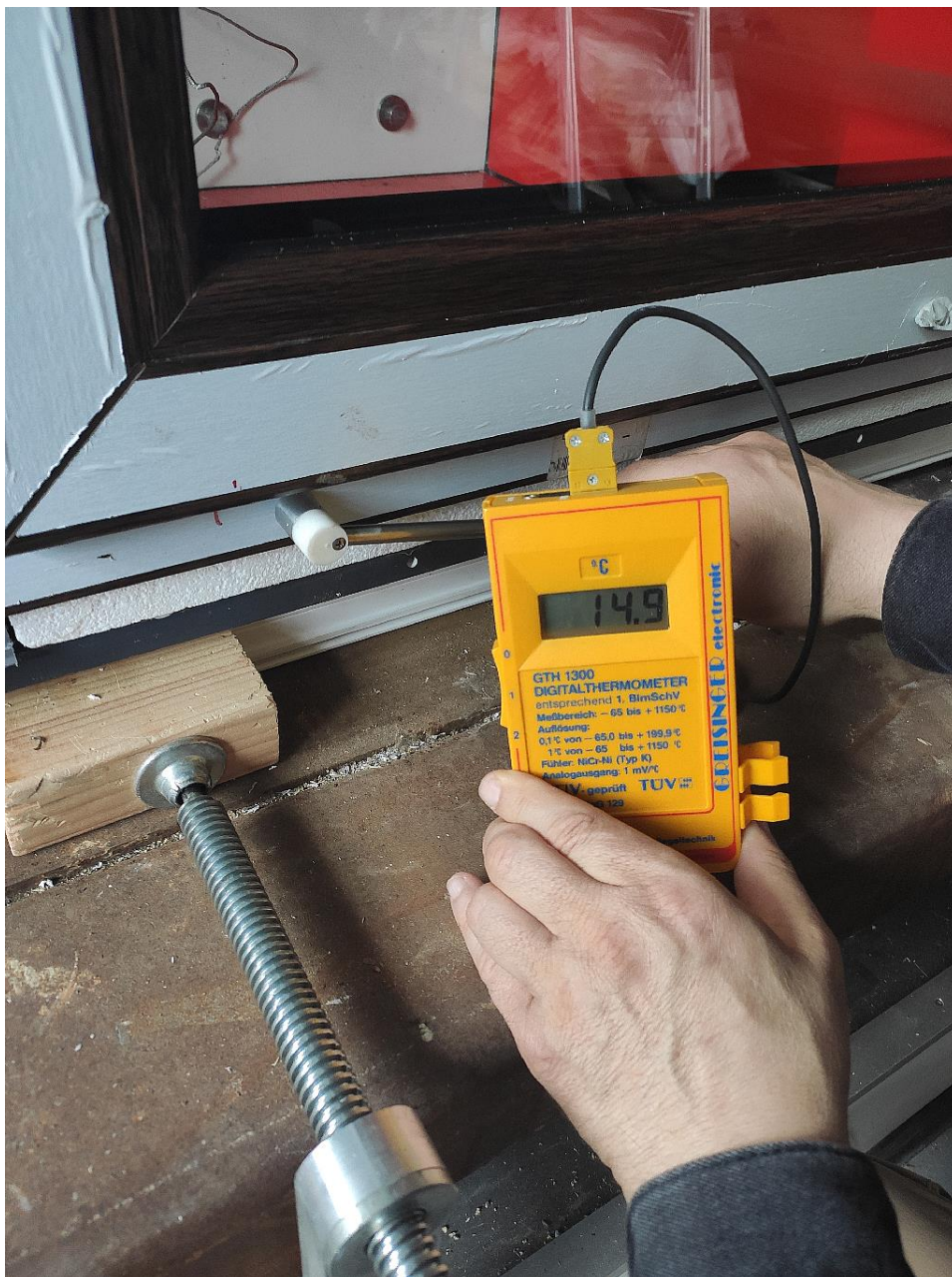
Рис. 12. Оконный блок Deseunick Favorit Space. Замер температуры поверхности рамы оконного Deseunick Favorit Space 76 мм.
